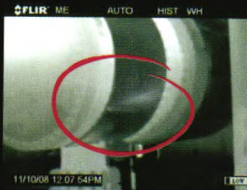
石化厂中的气体泄漏
