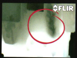
检测到的气体泄漏
