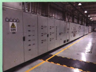
储能变流器及储能系统测试区
