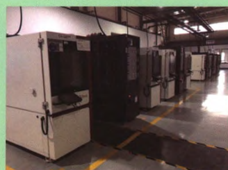
电池充放电性能测试区
