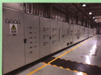
储能变流器及储能系统测试区
