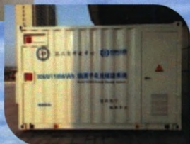
钠离子电池储能电站
