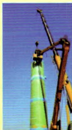
济南二环南路提升泵站 日排水量6850m 3 /d 筒径3800mm 高度16m 配3台 Q=950m 3 /h H=17m P=75kw 潜水排污泵
