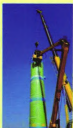
济南二环南路提升泵站 日排水量6850m 3 /d 筒径3800mm 高度16m 配2台 Q=950m 3 /h H=17m P=75kw 潜水排污泵
