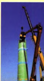
济南二环南路提升泵站 日排水量68500m 3 /d 筒径3800mm 高度16m 配2台 Q=950m 3 /h H=17m P=75kw 潜水排污泵
