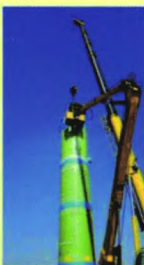
济南二环南路提升泵站 日排水量68500m 3 /d 筒径3800mm 高度16m 配3台 Q=950m 3 /h H=17m P=75kw 潜水排污泵
