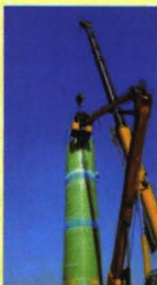
济南二环南路提升泵站 日排水量68500m 3 /d 筒径3800mm 高度16m 配3台 Q=950m 3 /h H=17m P=75kw 潜水排污泵
