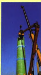
济南二环南路提升泵站 日排水量6850m 3 /d 筒径3800mm 高度16m 配3台 Q=950m 3 /h H=17m P=75kw 潜水排污泵
