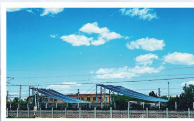
国家铁道试验中心铁路沿线分布式光伏发电先行示范段
