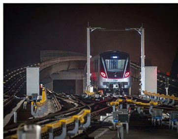
轨旁综合监测系统
