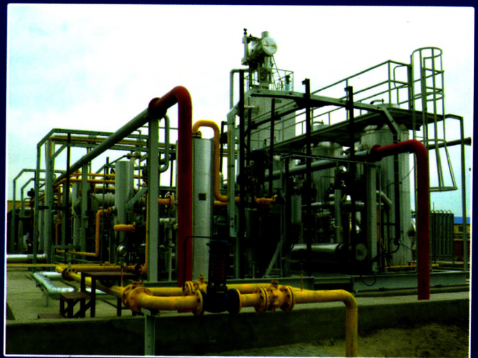
● 成功研发LNG（液化天然气）装置
