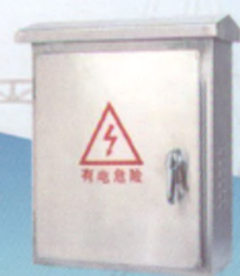
配变监测终端箱
