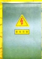
电力负荷管理终端箱
