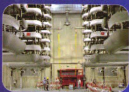
【特/超高压换流站 电气设备检测】
