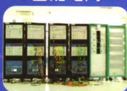
【智能变电站电气设备检测】
