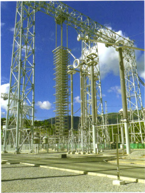
±800kV 糯扎渡直流工程悬吊式装置
