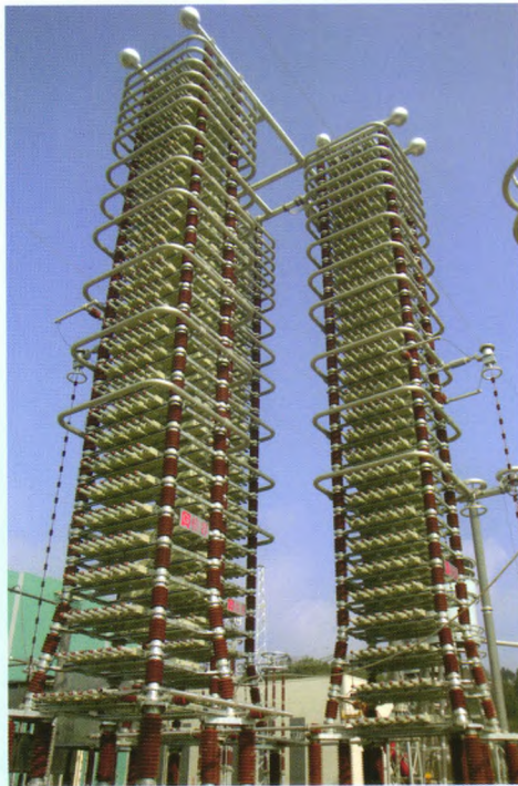
溪洛渡-浙西 ±800kV 特高压直流工程双龙换流站
