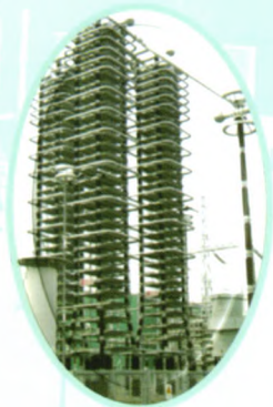
锦屏-苏南 ±800kV 特高压直流工程同里换流站
