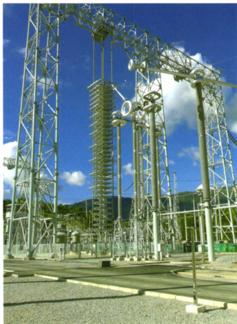
±800kV 糯扎渡直流工程悬吊式装置
