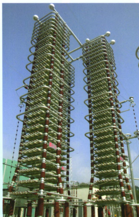
溪洛渡-浙西 ±800kV 特高压直流工程双龙换流站
