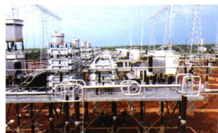
埃塞俄比亚500kV串补项目
