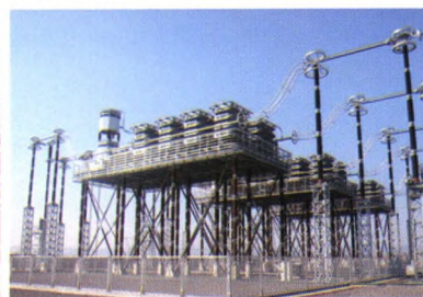
晋东南长治站1000kV特高压 交流串补装置示范工程
