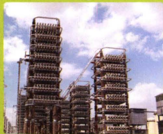
酒泉—湖南 ±800kV 特高压直流 输电工程换流站设备
