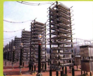
永仁—富宁 ±500kV 直流输电工 程换流站设备
