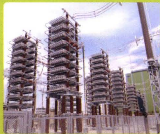
灵州—绍兴 ±800kV 特高压直流 输电工程换流站设备
