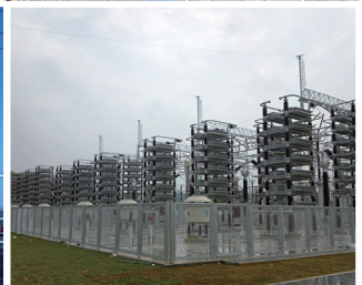
溪洛渡左岸—金华±800kV特高压直流输电工程
