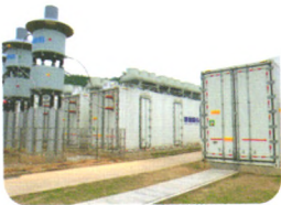
南方电网STATCOM 35kV / ±200MV·A, 基于IEGT技术, 设计容量320MV·A, 全球领先
