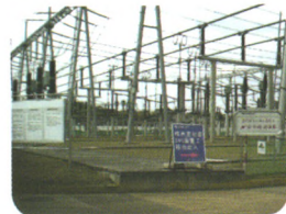
南方电网 SVC 单机容量210Mvar, 国内领先
