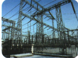
国家电网SVC 直挂电压等级66kV, 国际领先
