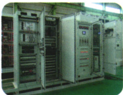
中石油西气东输管线 25MV-A特大功率变频系统, 填补 国内空白
