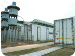
南方电网STATCOM 35kV / ±200MV-A, 基于IEGT技术, 设计容量320MV-A, 全球领先
