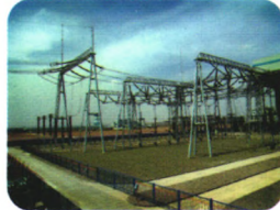
神华集团锦界电厂 次同步谐振动态稳定装置, 容量320Mvar, 国际领先
