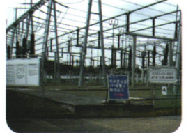
南方电网 SVC 单机容量210Mvar, 国内领先
