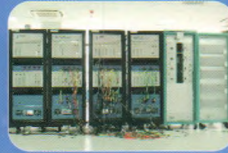
【智能变电站电气设备检测】
