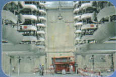
【特/超高压换流站 电气设备检测】
