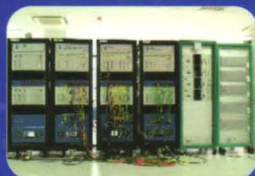
【智能变电站电气设备检测】
