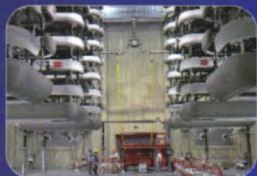
【特/超高压换流站 电气设备检测】
