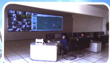
用户变电站电能远控中心
