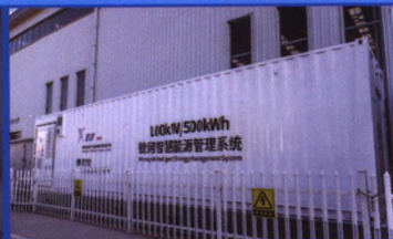
微网智慧能源管理系统
