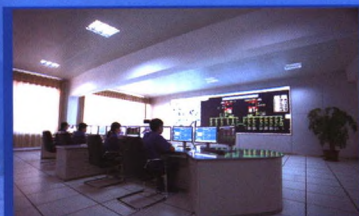
变电站智能运维远控中心
