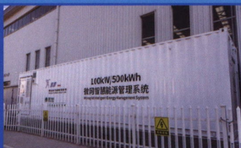
微网智慧能源管理系统
