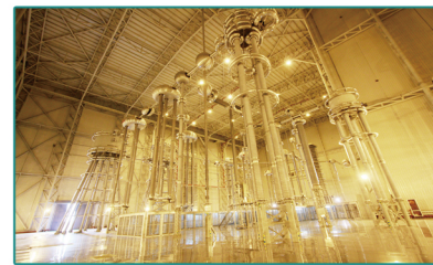
±1100kV换流站户内直流场
