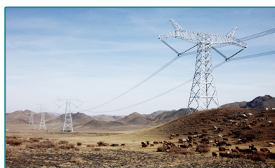
±1100kV直流输电线路
