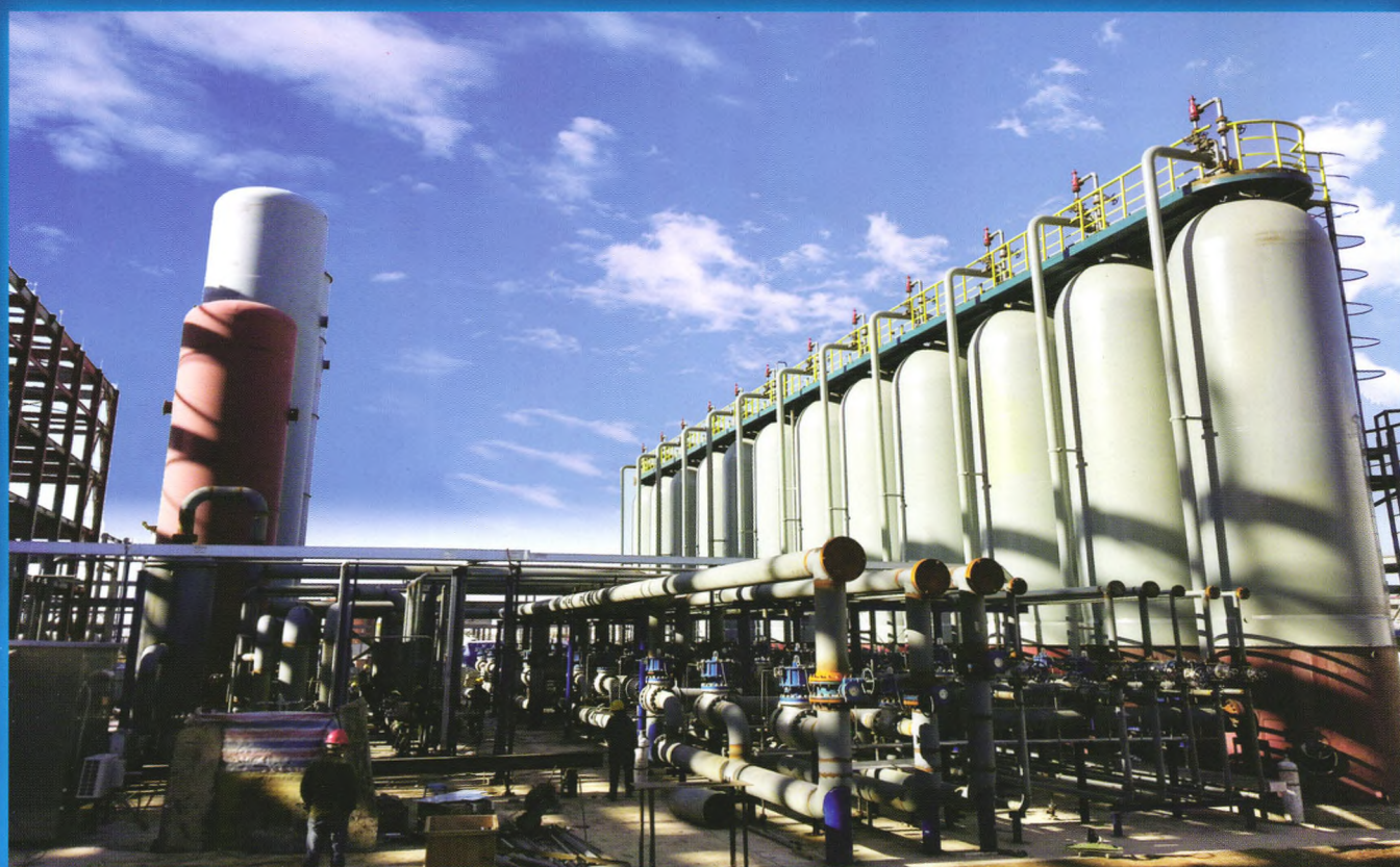
蒲城清洁能源化工有限责任公司70000Nm 3 /h甲醇弛放气PSA制氢装置
