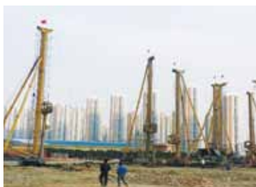
123 桩基础施工新技术专题讲座 (三十五) 内夯式沉管灌注 桩和非取土复合 扩底桩（上）
