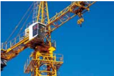
FO23B型塔机 断路器跳闸故障排查 52
