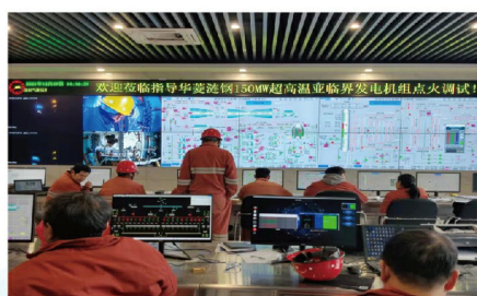
涟钢150 MW超高温亚临界发电项目
