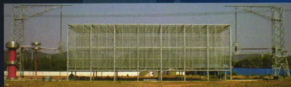
交流特高压电晕笼全景图
