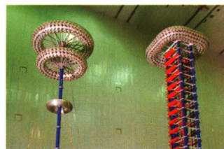
6 000 kV冲击电压发生器
