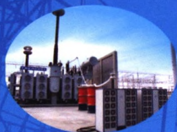
变压器感应耐压及局放试验系统
