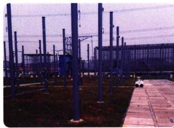
变电站智能巡检机器人试验
