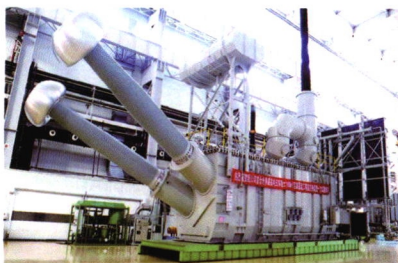
昌吉—古泉 ±1100 kV 直流输电工程用换流变压器
