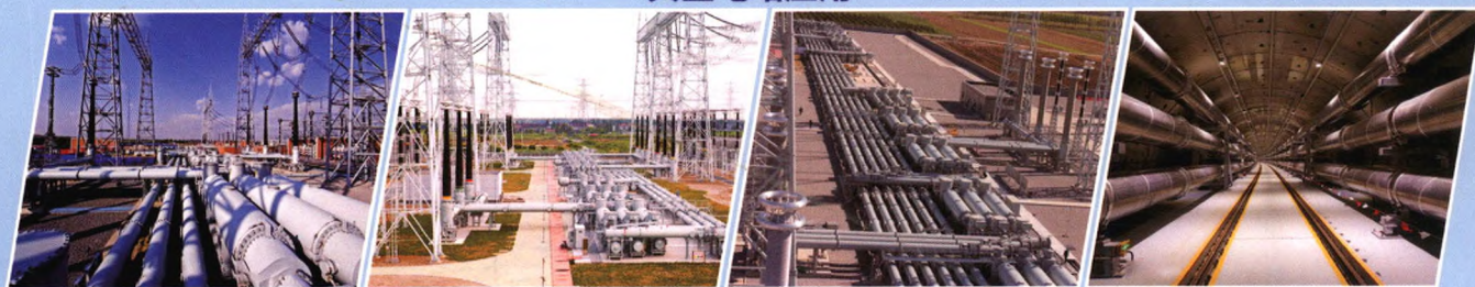
1 100 kV GIS 晋东南变电站
