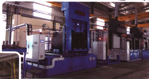
可控气氛多用炉生产线
