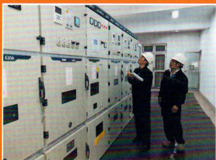
后勤水电工巡查配电设备
