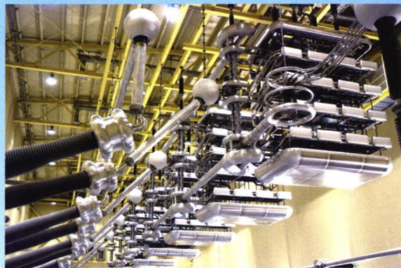
特高压±800千伏直流输电工程换流阀
