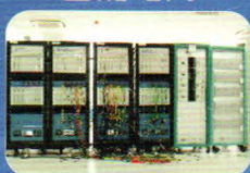
【智能变电站电气设备检测】
