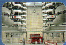
【特/超高压换流站 电气设备检测】
