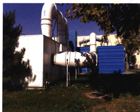
酒仙桥除臭装置
