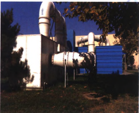
酒仙桥除臭装置
