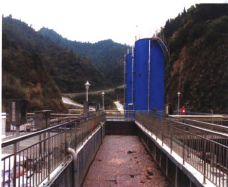
红菌技术在湖北十堰垃圾渗滤液处理厂的应用
