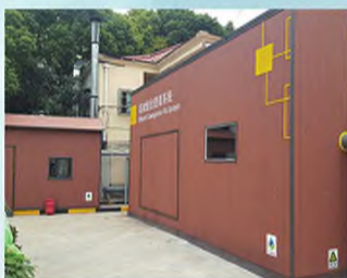
高效组合澄清系统 徐汇区康健泵站污染物消减项目
