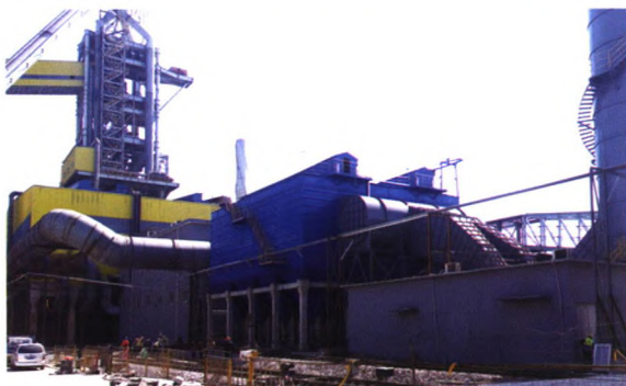
■ 东北特钢高炉出铁场布袋除尘器---运行中
