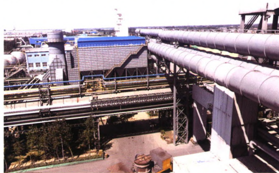
■ 澳森钢铁炼钢三次除尘---除尘器及管道
