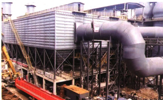
■ 津西钢铁2000m³ 高炉出铁场除尘
