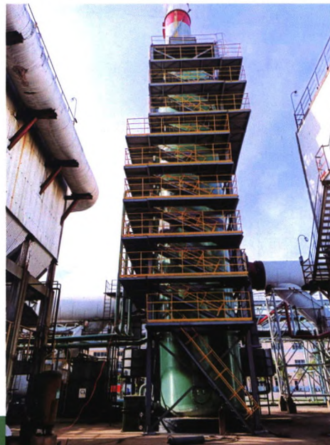
■ 广西梧州金升铜业脱硫系统---运行中
