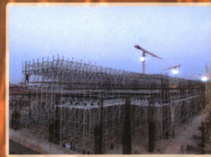
建设单位:北京城建集团有限责任公司义乌分公司 北京华盛天成工程科技有限公司 工程名称:义乌综合保税区一阶段(物流仓储一期)二标段工程项目 类别:承插型盘扣式钢管脚手架
