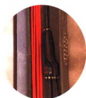
建筑电气竖井 配电应用
