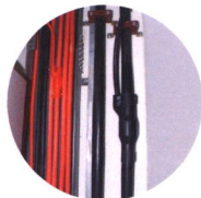
建筑电气竖井 配电应用
