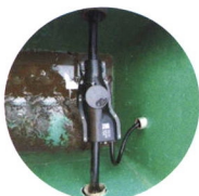
路灯/景观灯 配电应用
